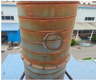
排气筒 P1 采样口
