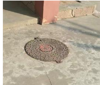
南厂区污水排放口
