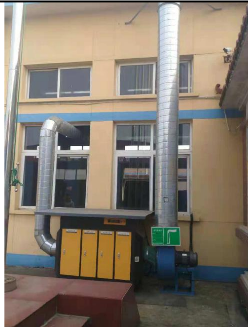
P2 排气筒标识牌
