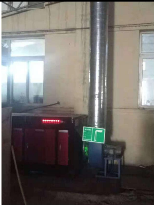
P1 排气筒标识牌
