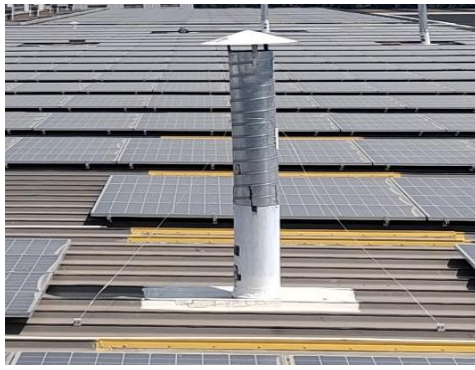
DA034 排气筒（本次扩建保留）
