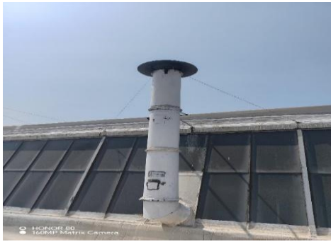
DA026 排气筒（本次扩建保留）
