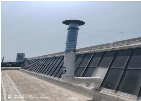
DA035 排气筒（本次扩建保留）
