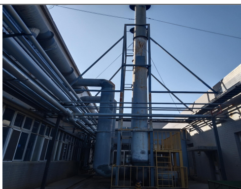
热处理 DA036 排气筒-1
