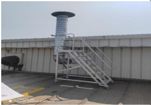
DA030 排气筒（本次扩建保留）
