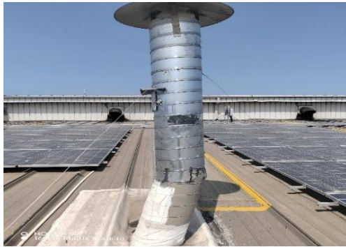
DA027 排气筒（本次扩建保留）
