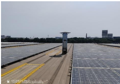
DA025 排气筒（本次扩建保留）
