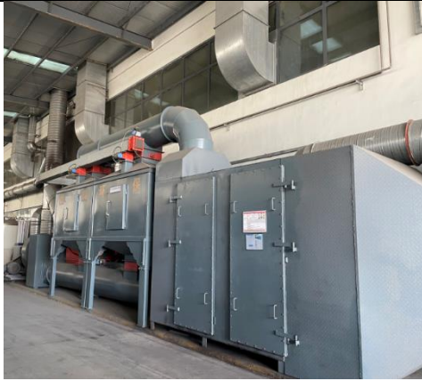
图 8 排气筒 P3 废气治理设施
