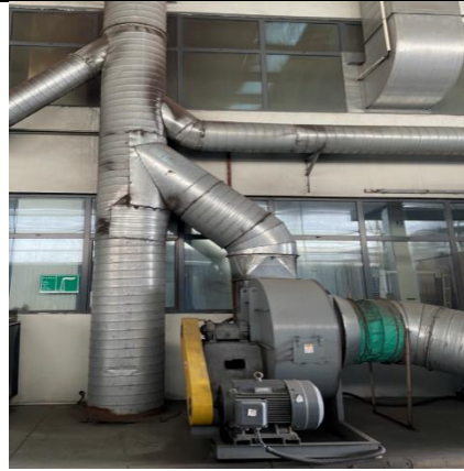
图 9 排气筒 P3 (喷漆、喷粉等)
