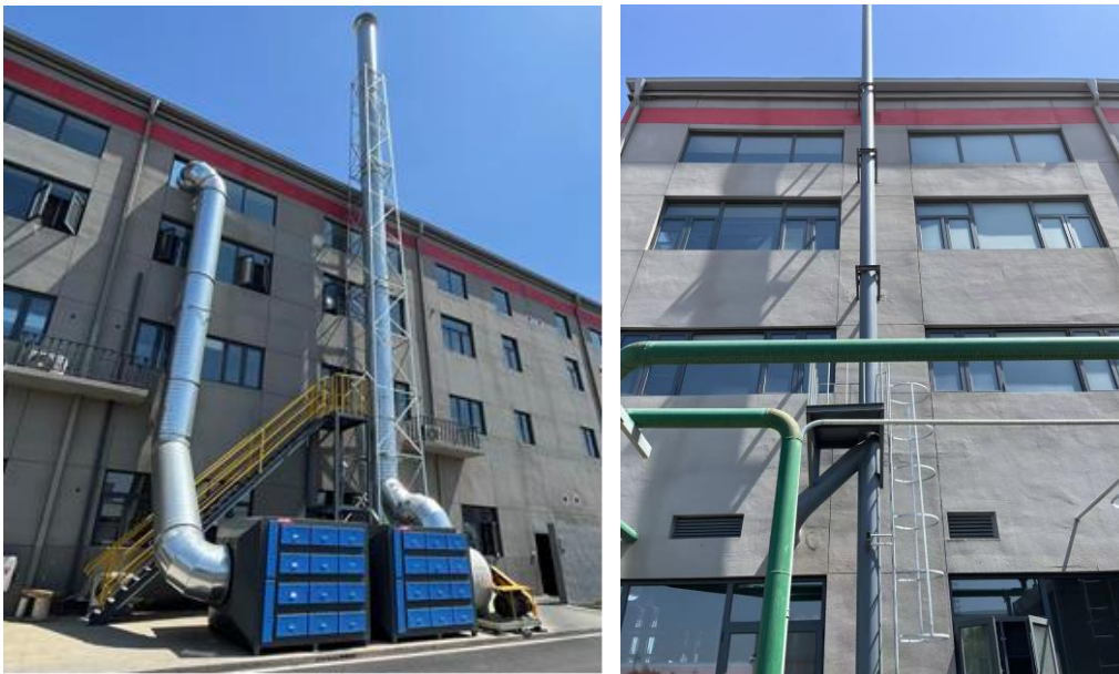
“二级活性炭吸附”装置及排气筒 DA005
